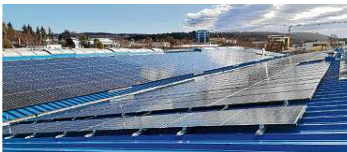
Die größte Photovoltaik-Dachanlage im nördlichen Hegau auf dem Dach der Engener Firma »allsafe« umfasst insgesamt rund 3.750 Quadratmeter Modulfläche und hat eine Leistung von 750 Kilowatt. Bild: allsafe
