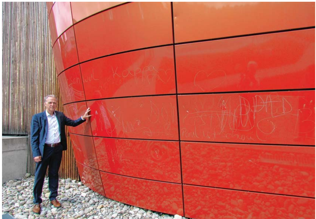
Kratzer, Beulen und Dellen: Bürgermeister Johannes Moser ist höchst erbost über die mutwillig verursachten Schäden an der schimmernden Alucobond-Fassade der neuen Stadthalle. Die Behebung der Schäden wird sich auf mindestens 25.000 Euro belaufen, die Installation von Überwachungskameras auf rund 16.000 Euro. Bild: Hering
